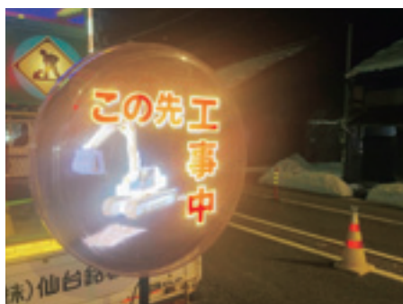
工事中注意喚起
